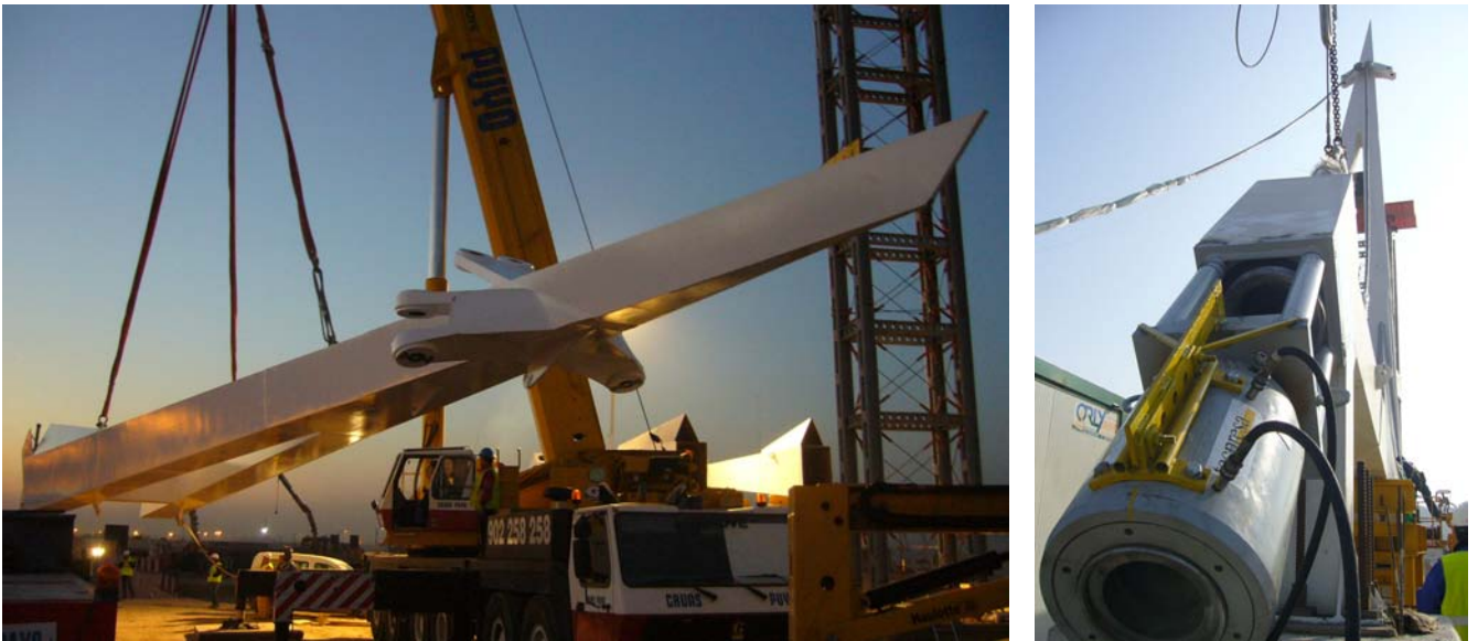
Fig. 14 Imágenes del izado del mástil metálico, y de la instalación y tesado inicial de los cables de retenida
